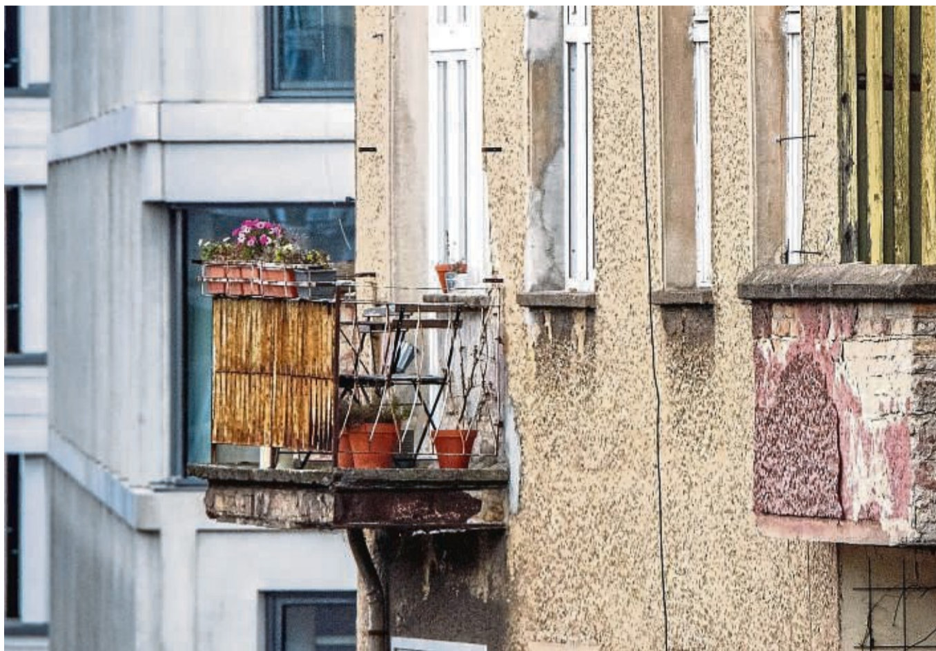
Einige Alarmsignale sollten Mieter und Eigentümer ernst nehmen: Risse im Beton, schiefe Holzteile oder Algenbildung können auf Schäden am Balkon hinweisen.
