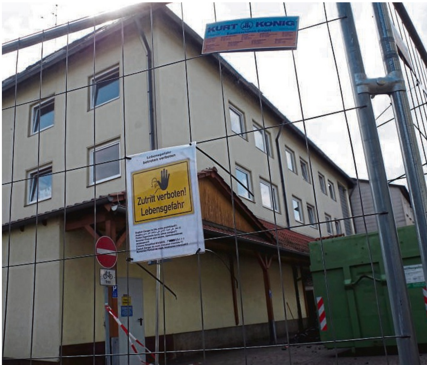
Durch das Feuer wurde das Mehrfamilienhaus nebst Geschäftsräumen unbenutzbar.
