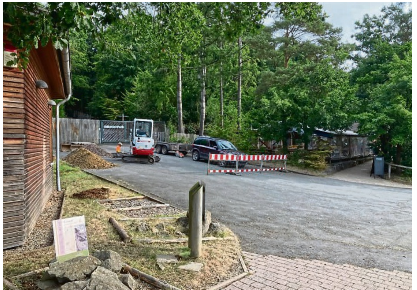
Bauauftritt: Mit Baggerarbeiten startet der Bau der neuen Sanitäranlagen am Wildtierpark. FOTO: NATIONALPARK KELLERWALD-EDERSEE
