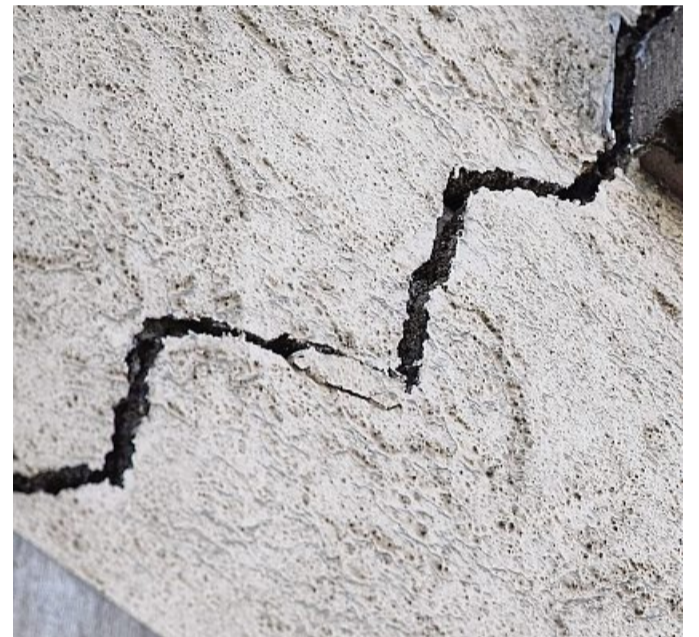
Ein kleiner Riss an der Fassade kann sich durch gefrierende Nässe schnell vergrößern - und große Schäden verursachen.
