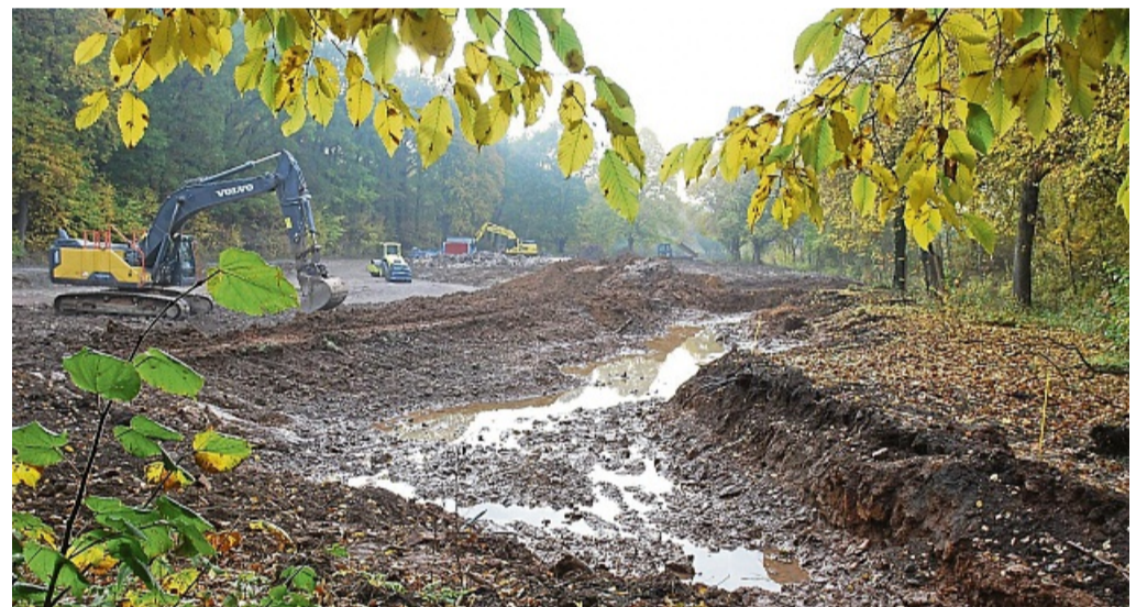
Für die Thiele wurde zwischen Birkenweg und Knusterweg ein neues Bett ausgehoben. Im zweiten Bauabschnitt soll nächstes Jahr der Abschnitt zwischen Birkenweg und Korbacher Straße renaturiert werden. ARCHIVFOTO: ARMIN HASS
