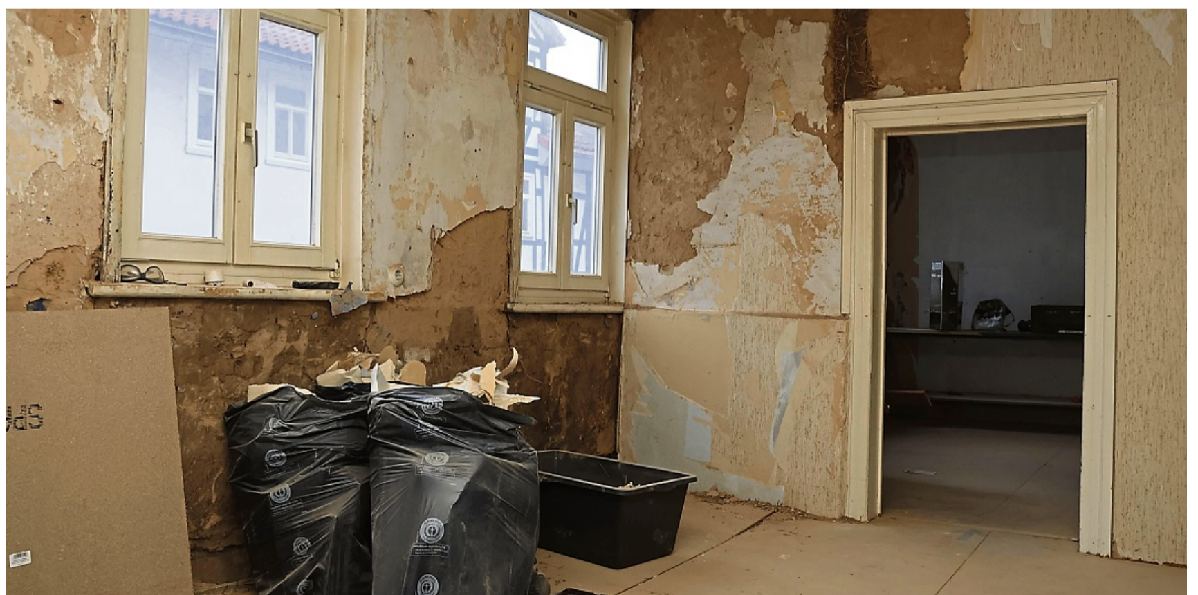
Noch viel zu tun: Im ersten und zweiten Stock des ZundA-Hauses Am Markt 8 in Witzenhausen gibt es noch Arbeit. Büros und Wohnraum soll hier entstehen.
