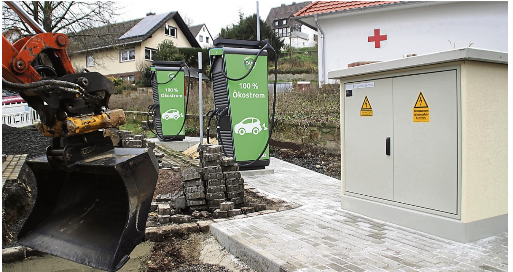
Strom schnell laden: Für Elektroautos gibt es jetzt in Gensungen zwei Ladesäulen. Bauherr und Betreiber der Anlage in der Nähe des DRK-Stützpunktes ist die EAM.
