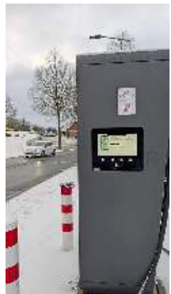
E-Ladesäule an der Ippinghäuser Straße in Wolfhagen.
