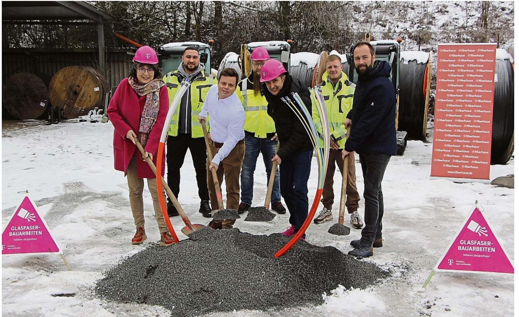
Spatenstich: Gestern Mittag begann trotz vereistem Boden der weitere Glasfaserausbau in Frankenberg für die Kernstadt und den Stadtteil Geismar. Symbolisch packten (vorne von links) Bürgermeisterin Barbara Eckes, Dominik Weyrauch (Glasfaser-Plus-Rolloutmanager West – Köln), Horst König (Telekom-Regiomanager – Frankfurt/Main) und Jürgen Saure (Fachbereichsleiter Stadtbaumt Frankenberg) bei den Arbeiten mit an. Im Hintergrund Vertreter der ausführenden Baufirma. FOTO: KLAUS JUNGHEIM
