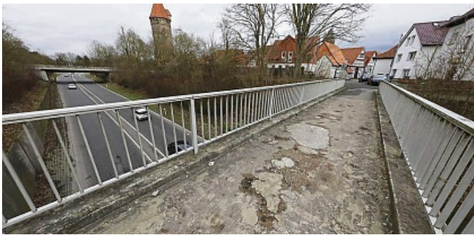
Die schadhafte sogenannte Seufzerbrücke über die B 83 in Grebenstein wird ab nächster Woche abgebrochen und erneuert.
