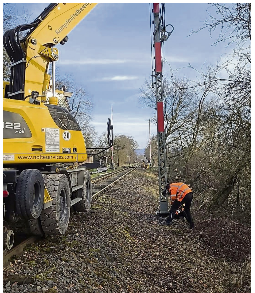
Das neue Formsignal vor der Schranke wurde erst kürzlich errichtet.
