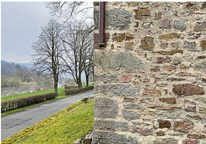
An allen vier Ecken der Kirche wurden die Regenfallrohre im unteren Bereich gestohlen. FOTO: KIRCHENGEMEINDE
