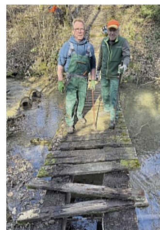
Die Brücke befand sich in einem maroden Zustand.
