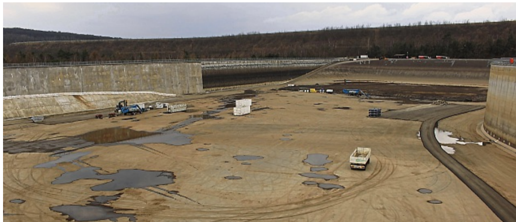
Leergespumpt: Im Sommer ist das kleine Speicherbecken während der Bauarbeiten leer, im Winter wird es weiter betrieben. FOTO: JAKOB BÜCHSENSCHÜTZ
