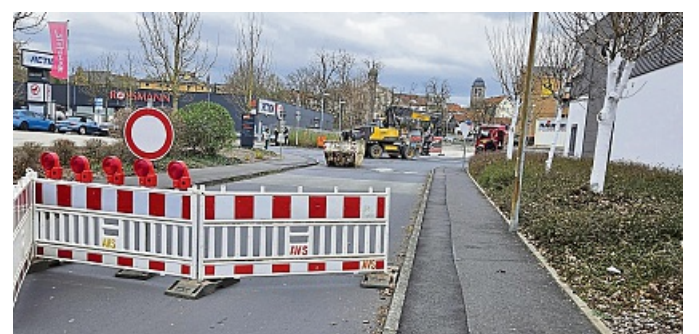
Kein Durchkommen: Der Kreuzungsbereich Heinrich-von-Stephan-Straße/Max-Becker-Straße ist während der umfangreichen Sanierungsarbeiten gesperrt. FOTO: MARC EICHE
