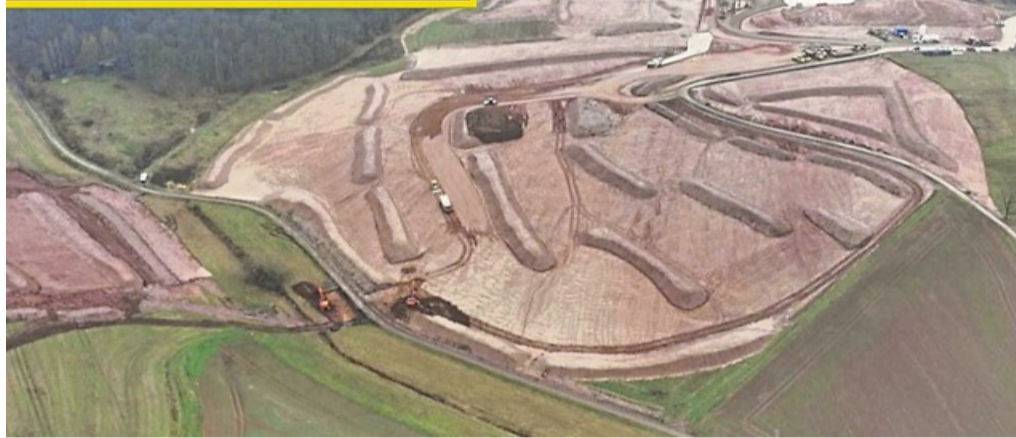
Autobahn 44 – Bauabschnitt Tunnel „Holstein“: Das Betreten der Autobahnbaustelle ist strikt verboten. FOTO: STADT SONTRA
