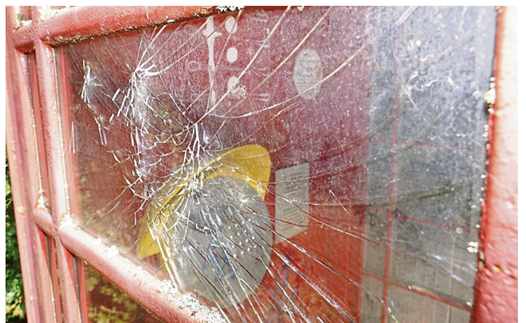
Gesprungen: Zwei der Glaskacheln sind beschädigt, mutmaßlich durch Vandalismus.
