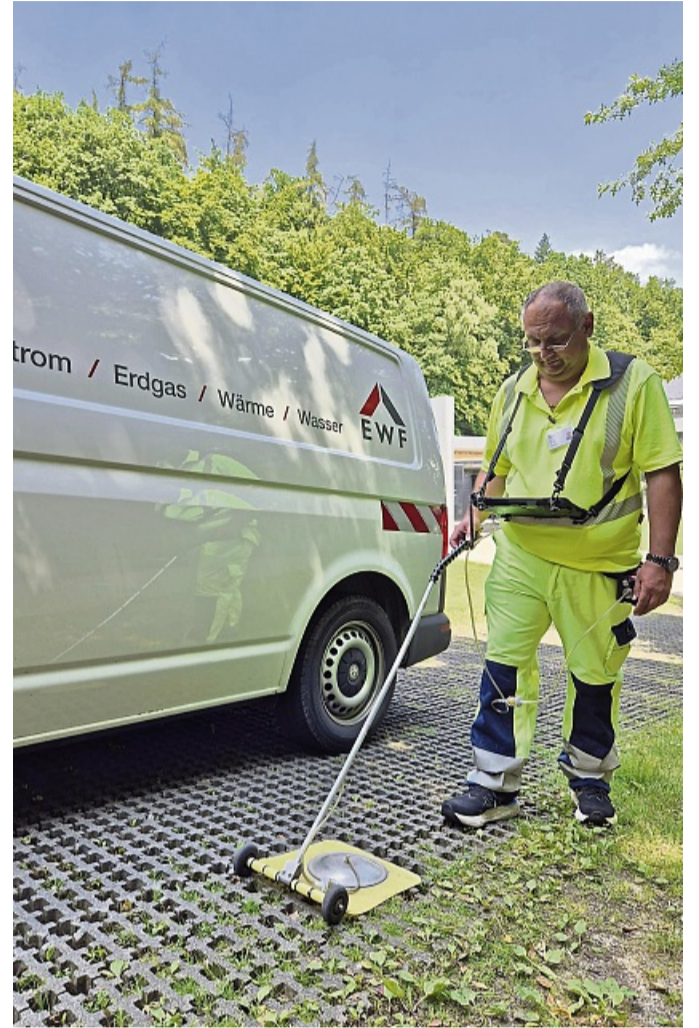
Gasprüfer kontrollieren im Auftrag des EWF Leitungen in Bad Wildungen. Sie verwenden feine Spürgeräte, um geringste Mengen Methan zu finden. FOTO: EWF/PR
