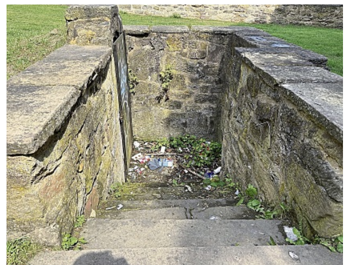
Vermauerter Kellereingang: Hier hat sich Müll angesammelt.
