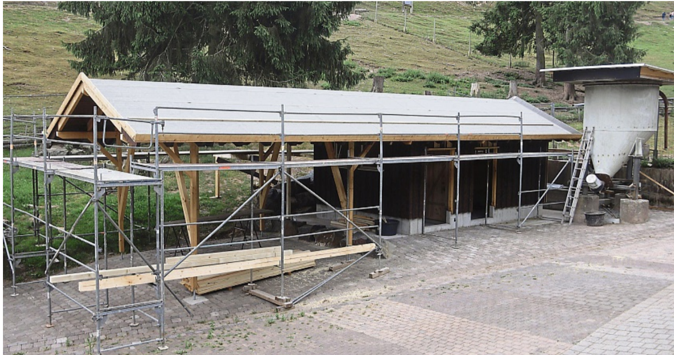
Der neue Stall für die Kamerunschafe im Frankenger Wildpark ist bereits im Bau. Zudem soll das Tiergehege auch mit weiteren Projekten weiterentwickelt werden.
