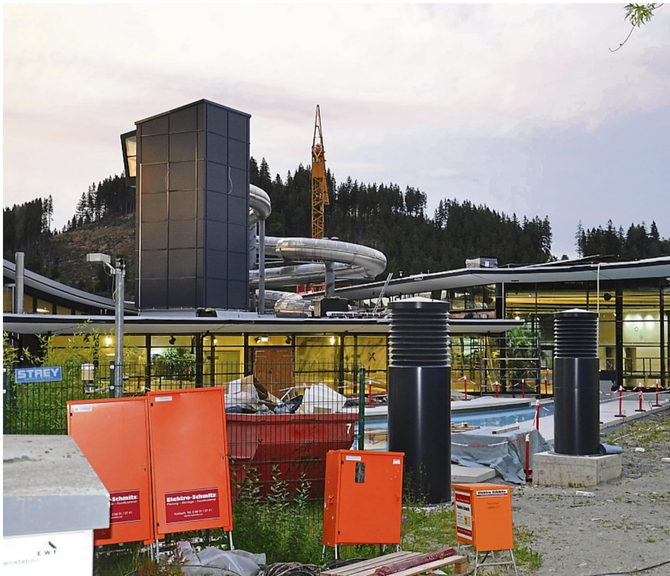
Die Glasfassade macht noch Sorgen: Die Insolvenz der Firma ist ein Hindernis beim Bäderbau.
