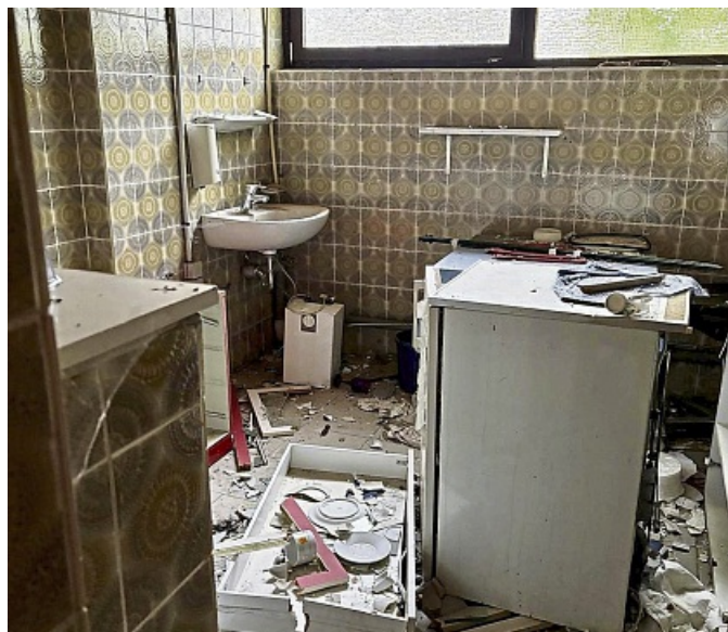
Opfer von Beschädigungen: Die alten Räume.
