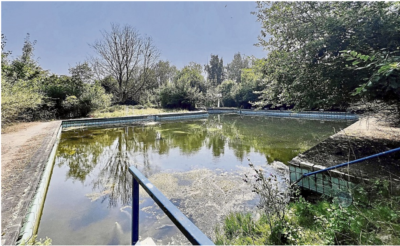
Seit Jahren nicht mehr in Betrieb: Das Freibad in Merxhausen. Vorne rechts im Bild ist die Rampe für die Erdkröten zu erkennen.
