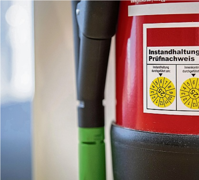
Instandhaltungs- und Prüfnachweise: Der Feuerlöscher darf nicht zu alt sein – eine regelmäßige Wartung ist wichtig.
