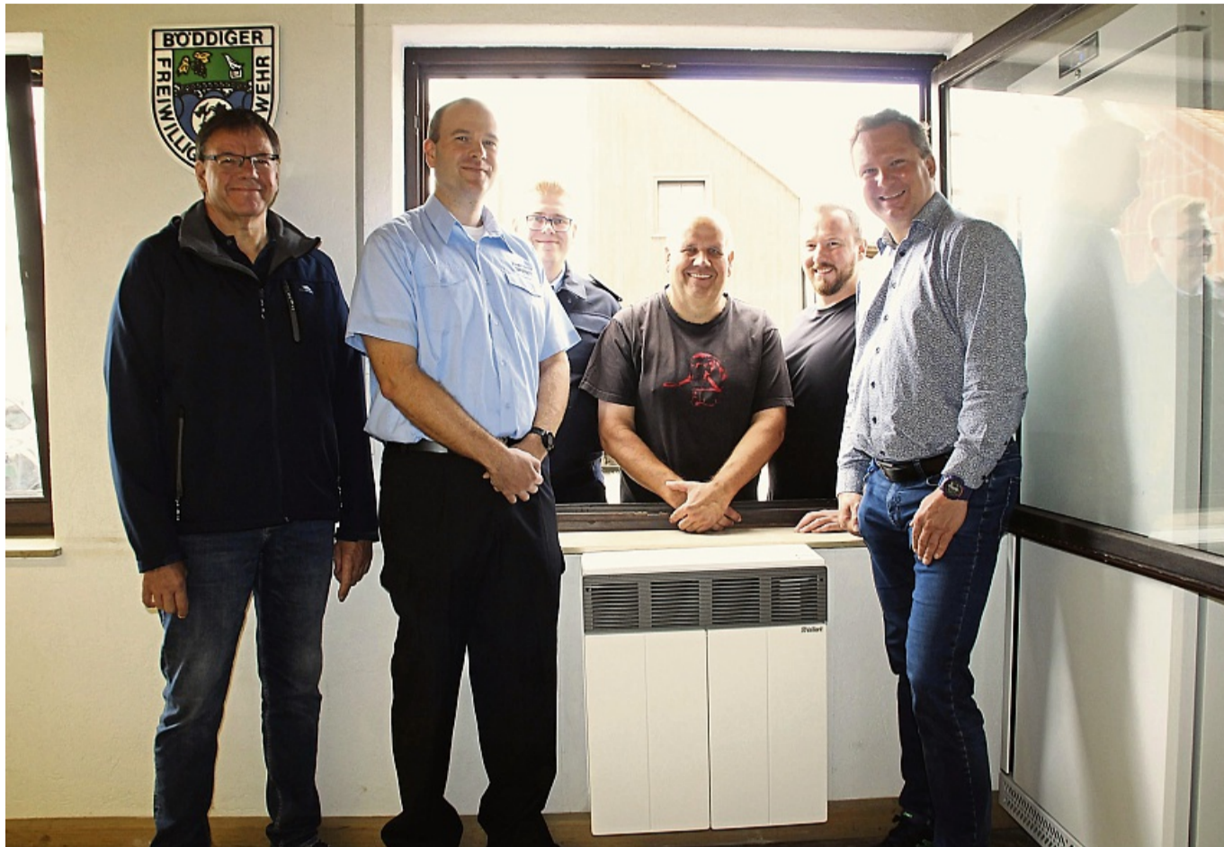
Freuen sich über die neue Heizung im Feuerwehrhaus Böddiger: Ortsvorsteher Bernd Steller (von links), Wehführer Daniel Kubiak, Christian Griesel und Bernd Pflüger von der Feuerwehr, Denny Günther von der Stadtverwaltung und Bürgermeister Björn Faupel.
