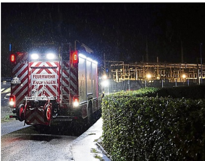
Die Wolfhager Feuerwehr wurde am Dienstagabend zu einem Einsatz am Wolfhager Umspannwerk alarmiert. Infolge eines Kabeldefektes entwickelte sich Rauch. FOTOS: HESSENNEWS TV
