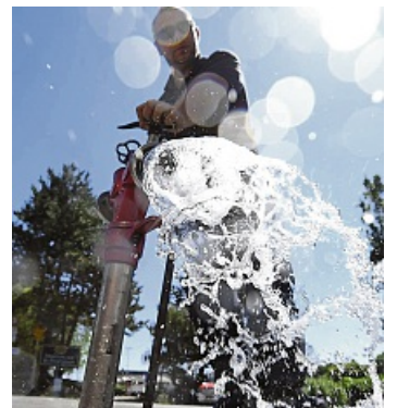
Die Hydranten in Ulfen werden überprüft und gespült.
