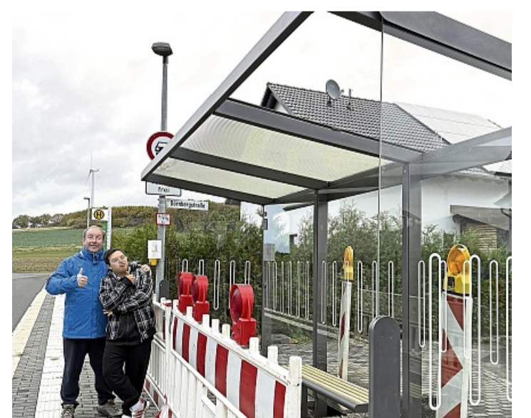
Freuen sich über das neue Dach: Michael Greiner und sein Sohn Jonas an der Körler Bushaltestelle. FOTO: CDU KÖRLE
