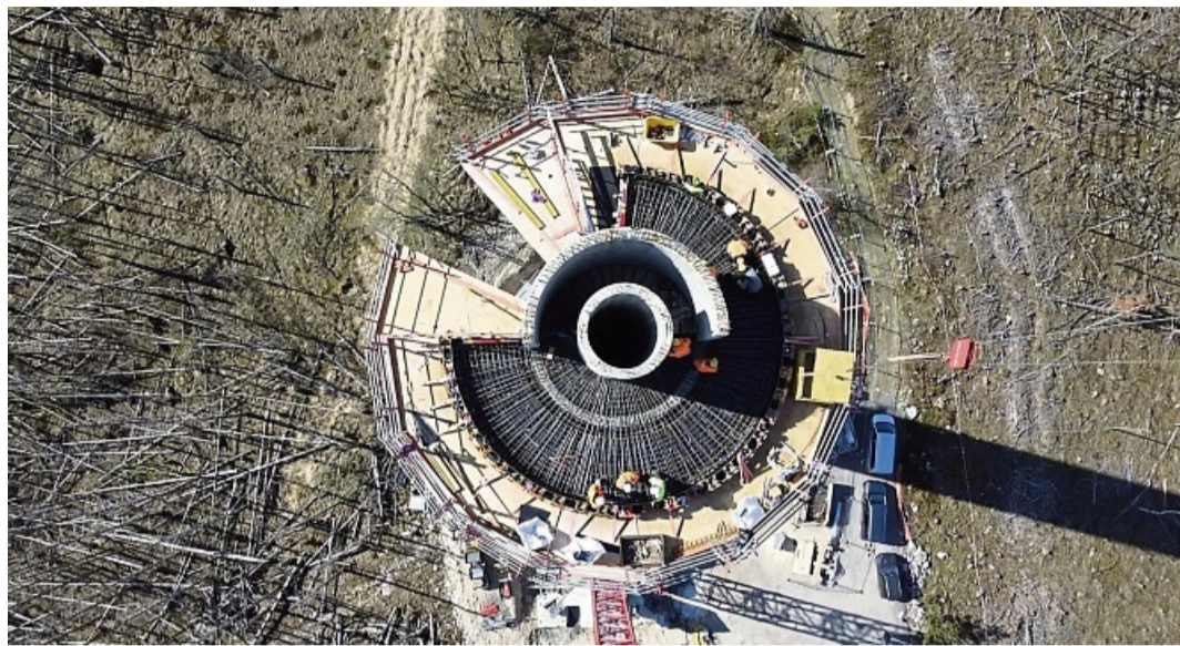
Ein seltener Blick von ganz weit oben: Wenn erst im Sommer die markante Radom-Kuppel aufgebracht wird, wechselt der Wasserturm auf dem Wüstegarten erneut die Optik.
