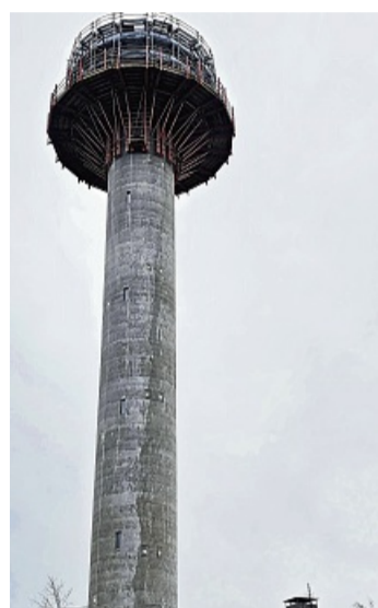
Schraubt sich hoch über den Kellerwald: Der 55 Meter hohe Wetterturm in Stahlbetonoptik.
