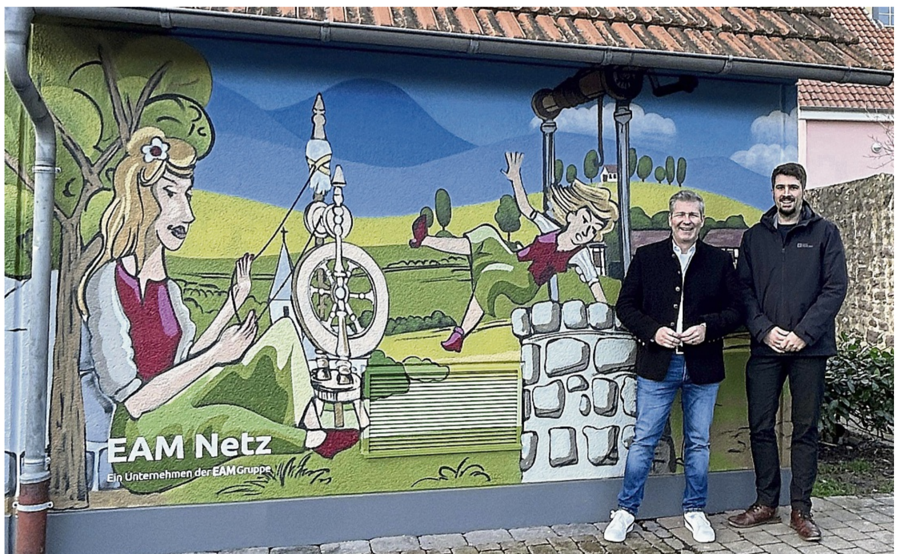
Besichtigung am Obertor: Bürgermeister Dirk Oetzel (links) und Niklas Stüber von der EAM vor der neugestalteten Ortsnetzstation, die technische Infrastruktur mit regionaler Bildsprache verbindet.
