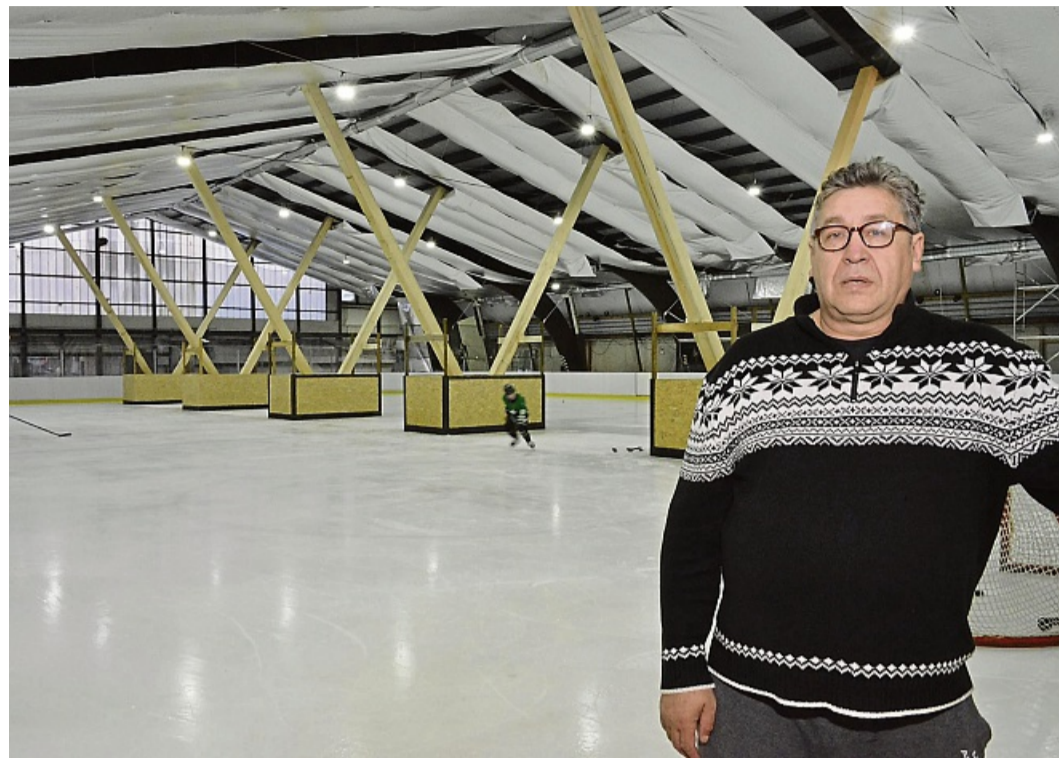
Stützen stabilisieren das Dach der Waberner Eissporthalle: Vassily Abramov ist froh, dass der Betrieb wieder läuft.
