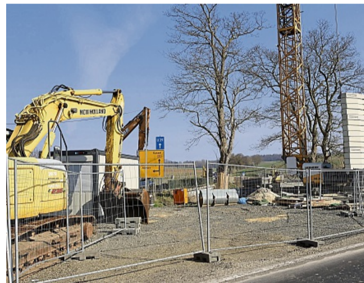
Es geht voran an der Baustelle für die Brücke der B254 über die Ems.
