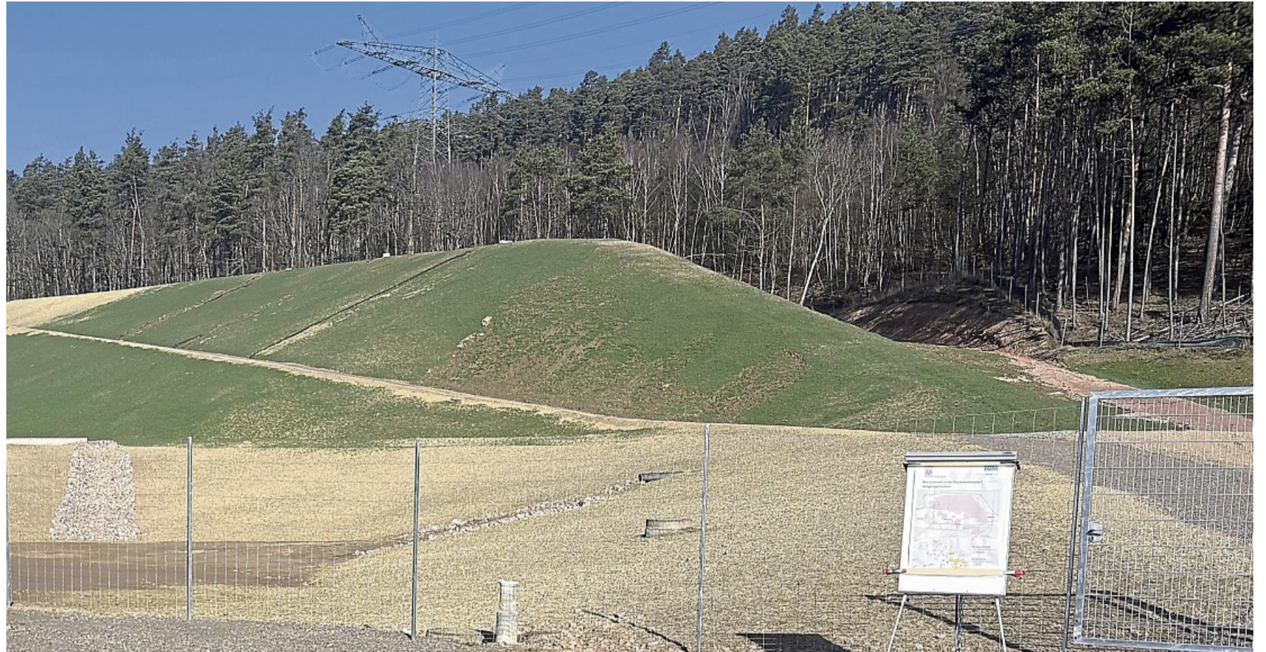
Die gesicherte Rückstandshalde an der Richelsdorfer Hütte: Mit mehreren Dichtungsschichten wurde sie so abgedeckt, dass möglichst keine Schadstoffe mehr ausgewaschen werden. FOTO: HIM GMBH, BEREICH HIM-ASG
