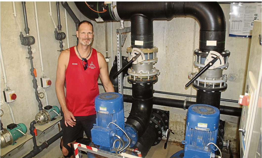
Modernste Technik: Hier kommt der gesamte Strom für das Ernst-Schaake-Bad an, der nicht weit entfernt von der PV-Anlage auf dem Dach der neuen Kindertagesstätte Villa Kunterbunt erzeugt wird. Im Bild Bad-Betriebsleiter Stephan Belz. FOTOS: MANFRED SCHAAKE
