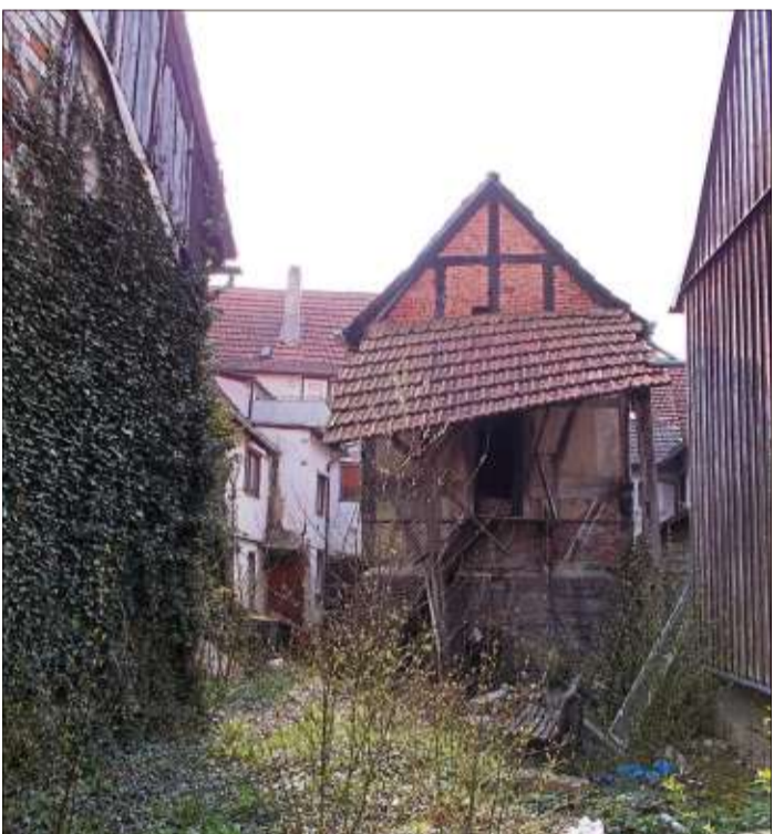
Das Gebüsch steht zum Teil mannshoch, das Vordach macht keinen vertrauenswürdigem Eindruck und ist, wie das gesamte Gebäude, abrissswürdig.
