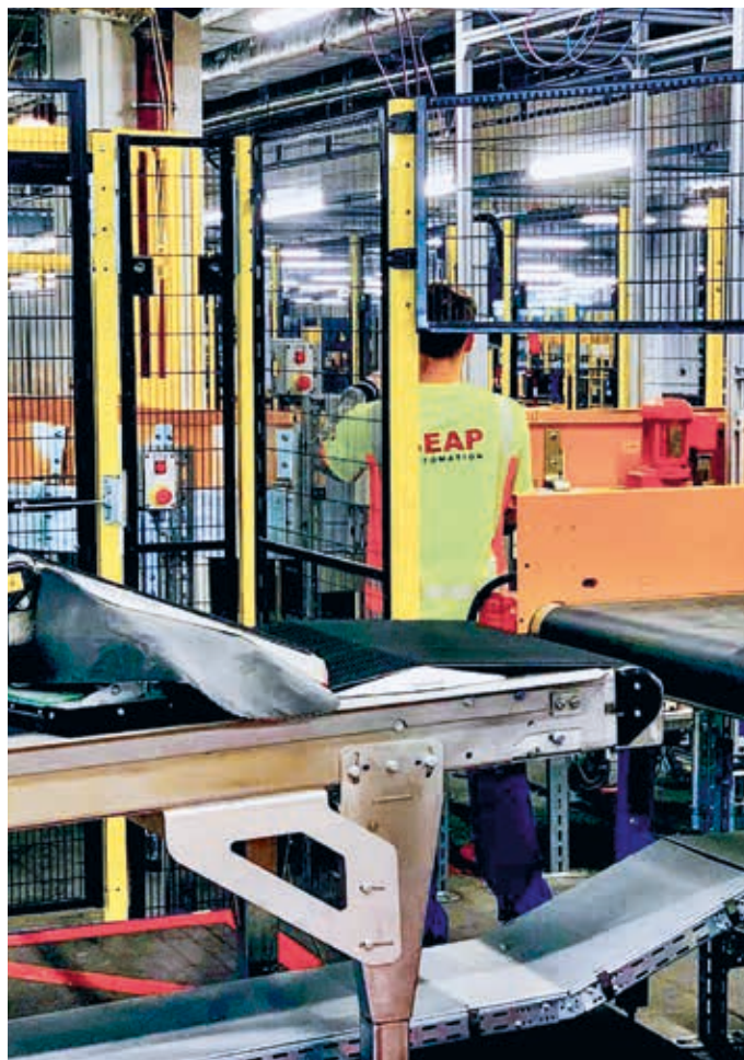
Inbetriebnahme der Gepäckförderanlagen am Frankfurt International Airport.
