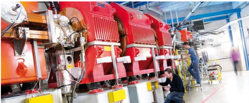
Der Speicherring ESR bei GSI.
