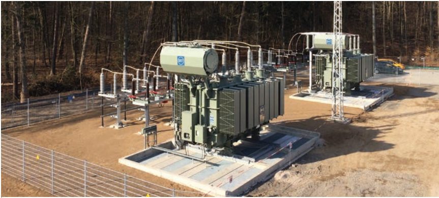
Umspannanlage Nord auf dem FAIR-Baufeld.
