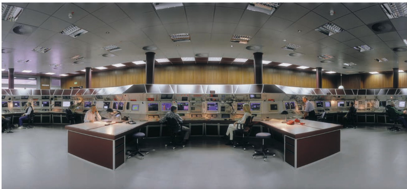
Der Hauptkontrollraum bildet das Herz der Beschleunigeranlage. Das Panorama zeigt die Konfiguration aus dem Jahr 1998.
