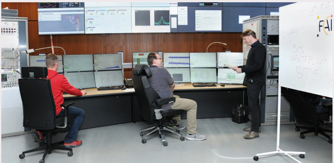
Im Hauptkontrollraum läuft der Betrieb der Beschleunigeranlagen weiter. In dem weitläufigen Bereich kann unter Einhaltung der Abstandsregelungen gearbeitet werden.
