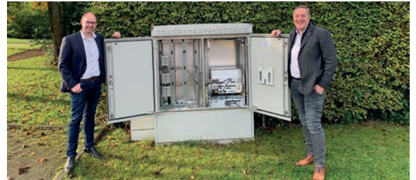
Bürgermeister Michael Hahn (rechts) und Peer Kohlstetter (Geschäftsführer YplaY) vor einem Verteilerschrank mit Glasfaserkabeln und Technik von YplaY in Assenheim. Foto:YplaY
