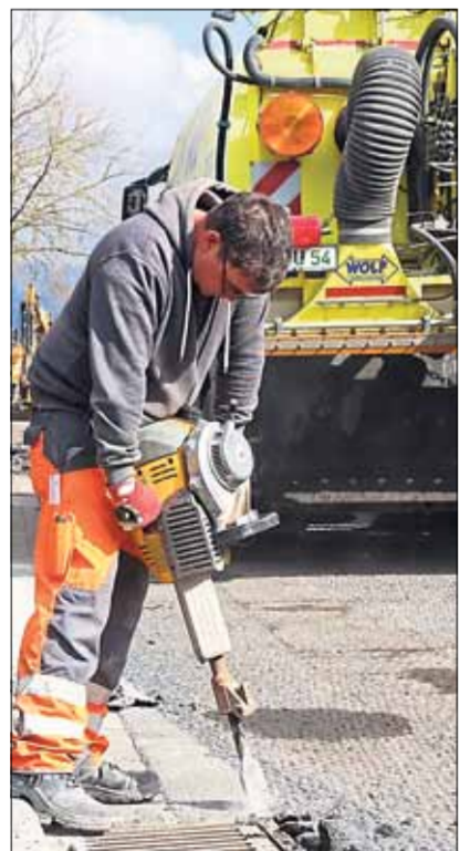
Bevor eine Straße neu asphaltiert werden kann, muss erst mal der alte Belag weg.
