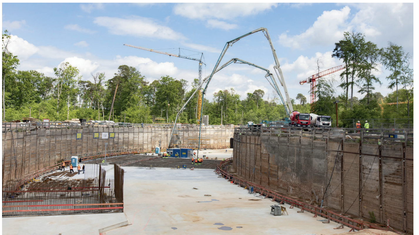
Wo vor wenigen Jahren der erste Spatenstich gesetzt wurde, ist nun ein wichtiger Schritt erreicht: Die Rohbauarbeiten für den SIS100 sind vollendet. Foto: PORR Deutschland
