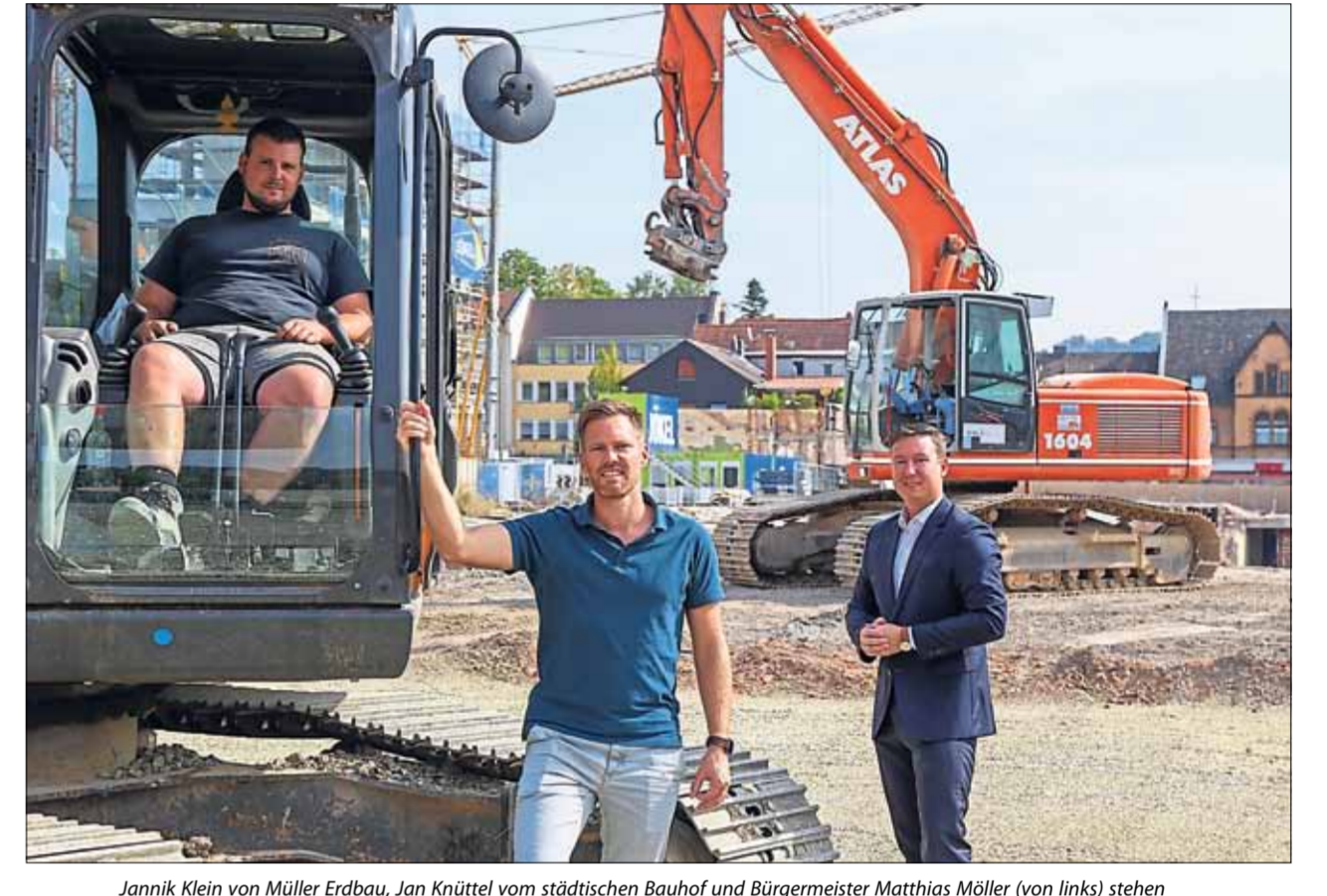
Jannik Klein von Müller Erdbau, Jan Knüttel vom städtischen Bauhof und Bürgermeister Matthias Möller (von links) stehen dort, wo das Kultur- und Begegnungszentrum bald sein wird. Fotos: Stadtverwaltung Schlüchtern
