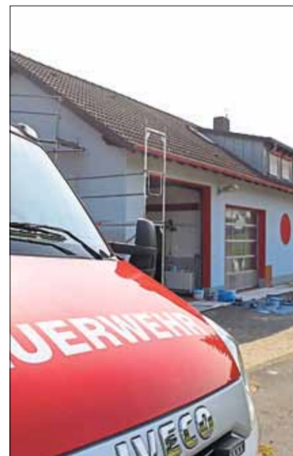
Der Feuerwehr-Stützpunkt in Hohenzell bekommt – genau wie der in Niederzell – eine neue Fassade verpasst.
