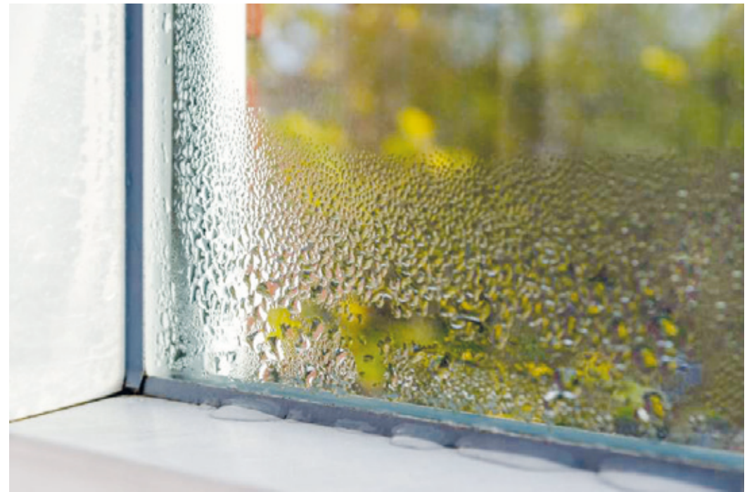
Feuchtigkeit in der Wohnung und als Ergebnis ein erhöhter Energiebedarf: Ein Austausch alter Dichtungsprofile ist dann oftmals unerlässlich. Foto: djd/GfA-Dichtungen/Getty Images/nadsja
