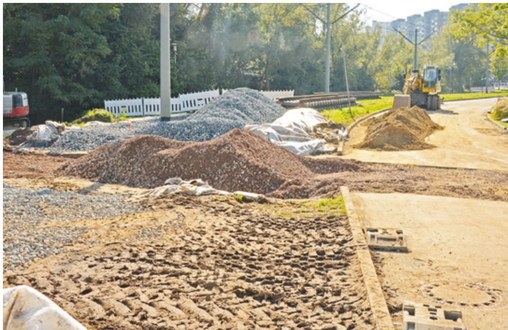
Straßenbahnschienen herausgerissen, Verkehrsstraßen verwüstet – kein Straßenbahnbetrieb mehr möglich auf Kranichsteins Bartningstraße.
