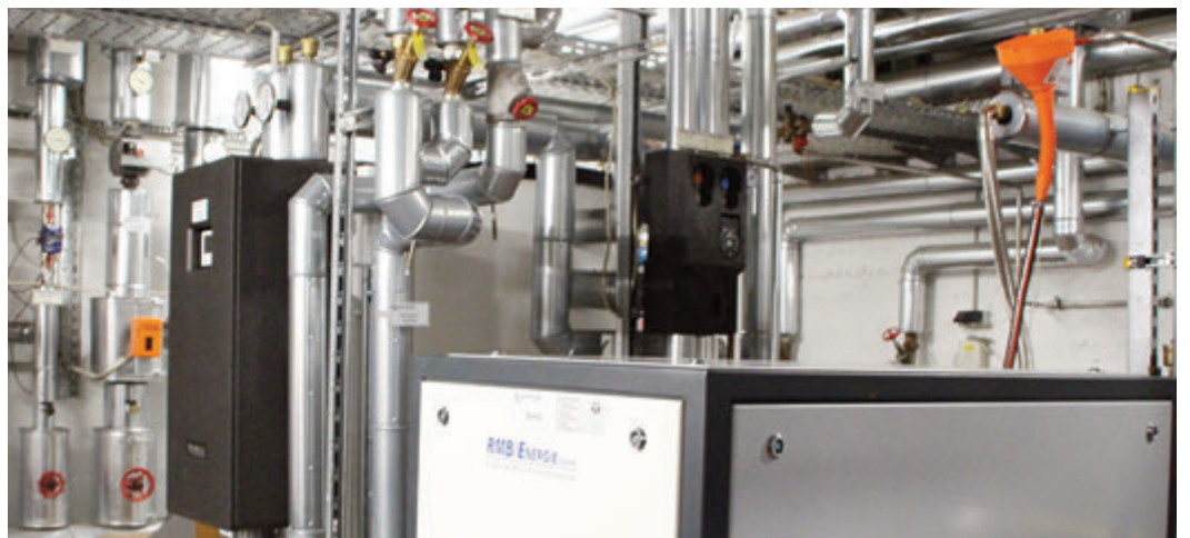
Energieversorgung in der Stadthalle.
