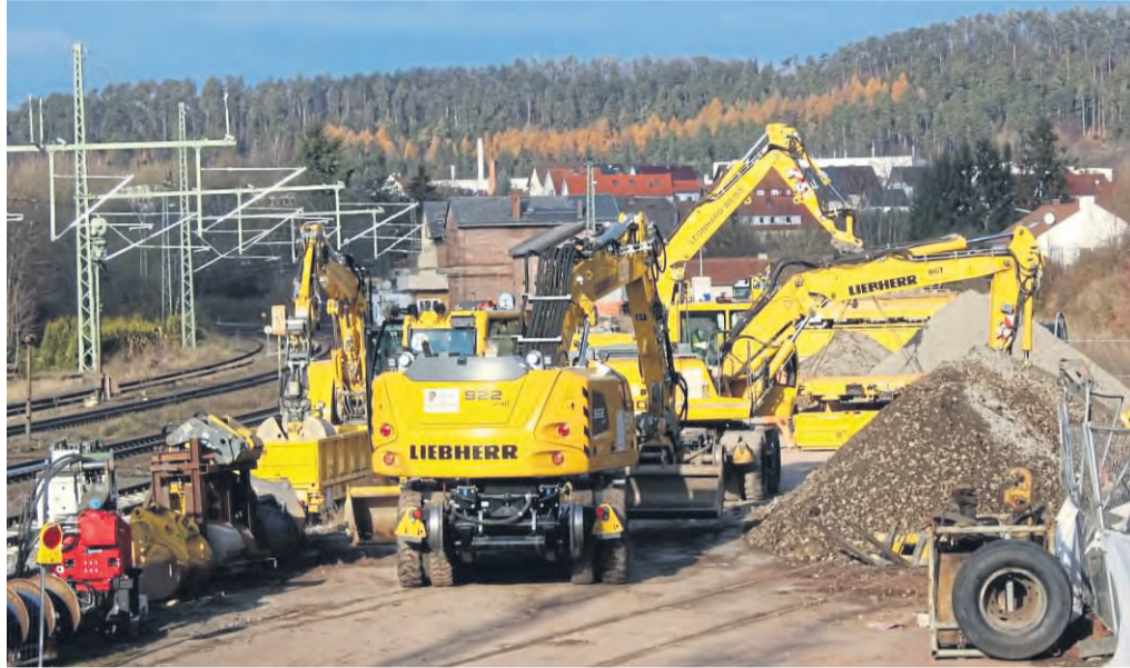
Viele Bagger sind seit eineinhalb Jahren im Bahnhof Sterbfritz, wo umfangreiche Bauarbeiten stattfinden, im Einsatz.
