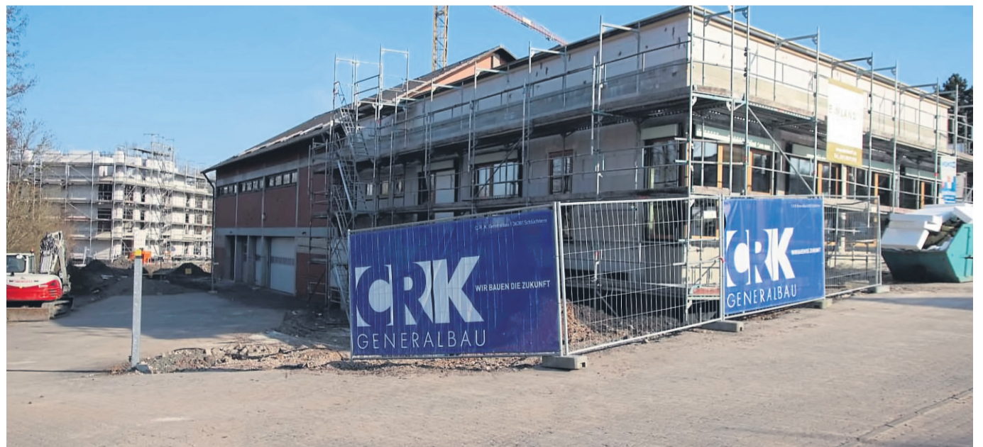
Vorne auf dem Knothe-Areal entstehen eine Arztpraxis und das Fitnessstudio, im hinteren Bereich (links) seniorengerechte Wohnungen.
