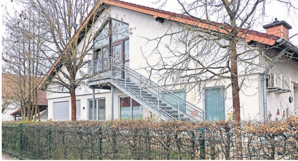
Die Kita St. Sebastian verfügt über Mängel im Brandschutz. Ein Teil wurde vom Bauhof schon behoben, um den Rest kümmern sich in den nächsten Tagen Fachfirmen. (Fotos: micha)
