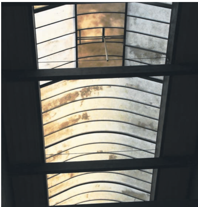
Bei näherem Hinsehen ist die Verdreckung der Dachlichtbänder in der Eppertshäuser Sporthalle klar zu erkennen. Durch ihre Erneuerung soll ab dem neuen Schuljahr mehr Sonnenlicht auf die Sportfläche der Dreifeldhalle fallen.
